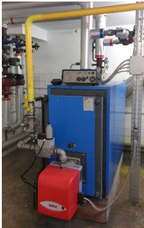
Figura 4-8 - Particolare della caldaia
