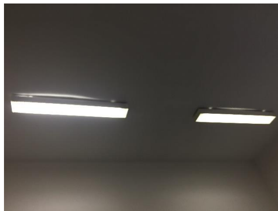
Figura 4-10 - Particolare dei corpi illuminanti
